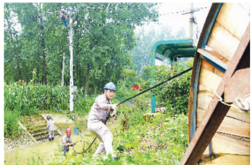
7月10日,洪泽区供电公司员工在高良涧镇贺家村11组台变更换0.4千伏3至8号杆绝缘导线。
