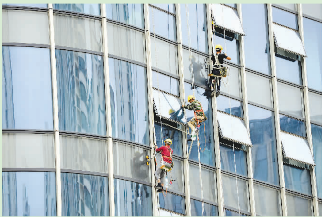
近日，工人在市金融中心玻璃幕墙上安装灯光设备。市金融中心建设进展顺利，楼顶停机坪、玻璃幕墙等配套设施建设工作稳步进行。
