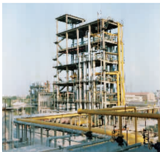
上世纪60年代初,建成投产的化工造气车间分离装置
