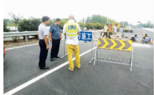
9月5日,洪泽区路政大队对247省道草泽湖大桥施工现场进行监管,查看了施工现场和施工进度,对施工现场设置安全标志工作进行了指导。针对247省道车流量大、通行速度快等特点,该大队要求施工方加强夜间施工现场的巡查,对突发问题进行及时消除,确保该路段通行畅通。 ■ 徐杰 徐宁 崔万通
