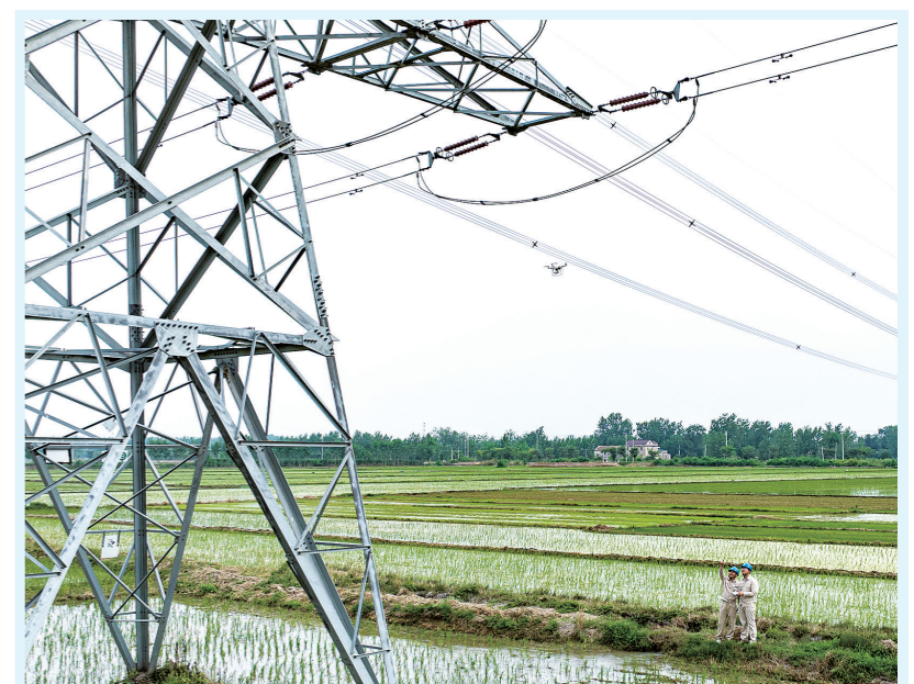
进入夏季用电高峰，国网涟水县供电公司组织线路运维人员加大对全县范围内输电线路及重要地段铁塔的巡检力度，掌握线路运行状况，及时排查安全隐患，确保供电安全可靠。图为近日，该公司员工利用无人机巡检220千伏输电线路。
