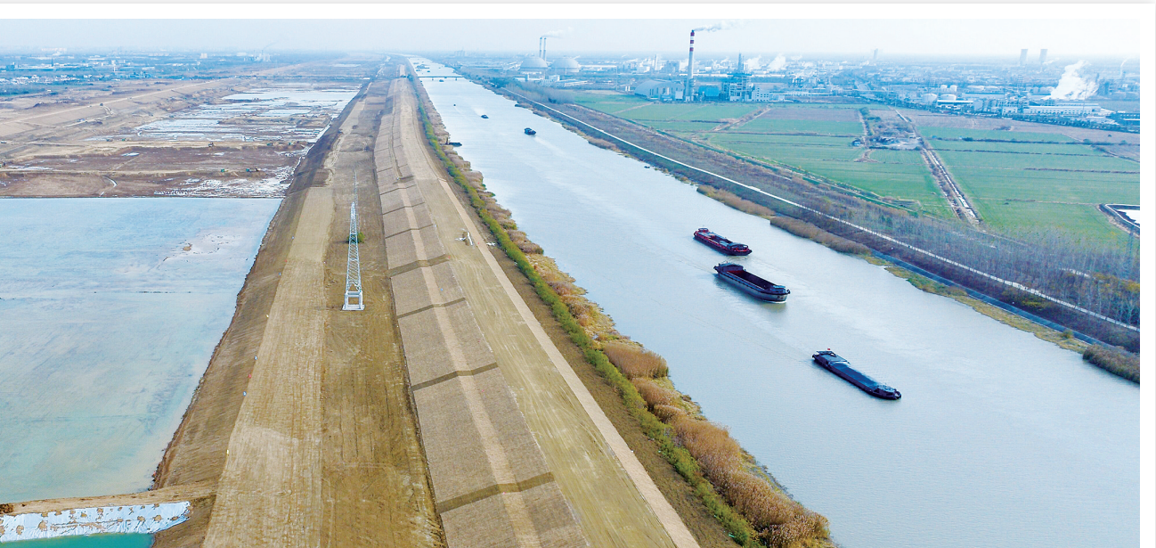
淮水汤汤终入海,一渠碧水利万代。当前,淮河入海水道二期工程的建设者们抢时间、赶进度、保工期,用智慧和汗水修建一条造福万千人民群众的泄洪通道、生态廊道、黄金水道,助力清江浦区高质量发展。图为日前,淮河入海水道二期工程清江浦区境内建设现场。
