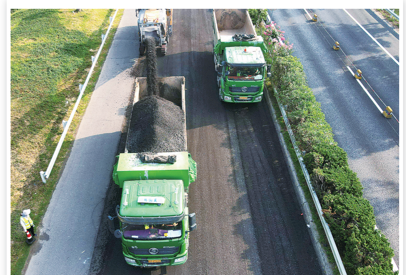
总投资2000多万元的327省道涟水段4.74公里大修工程项目,由涟水丙辰工程养护有限公司中标施工。日前,工人们避开高温时段抓紧作业,在保证质量和安全的前提下加快施工。图为机械施工现场。
