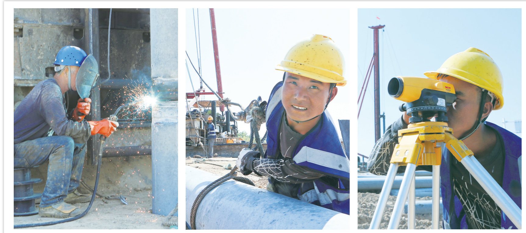
重特大项目建设进行时 昨日，在我市重特大项目中天钢铁集团(淮安)新材料有限公司精品钢帘线生产项目现场，工人们正在进行桩基施工。连日来，在做好疫情防控工作的同时，该公司全部达产后预计年产150万吨超高强精品钢帘线的项目工程全力推进。 ■融媒体记者 刘志钧 通讯员 王跃进
