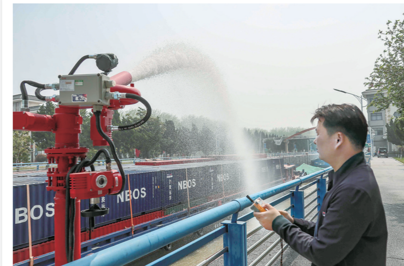
全省内河首套危化品运输 专用通道消防系统投入使用
